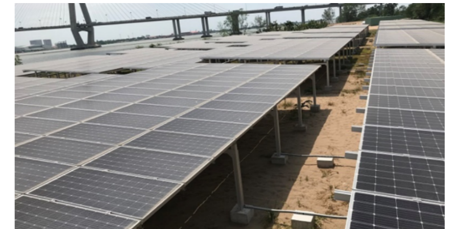
Hình ảnh Trạm pin năng lượng mặt trời công suất 500KWp tại Côn Ấu, TP.Cần Thơ
